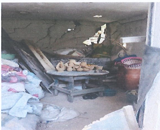
Foto: Vivienda en riesgo
