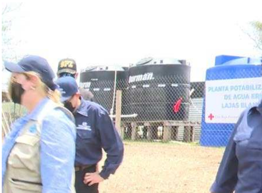
Planta potabilizadora de agua en la ERM de Lajas Blancas.
