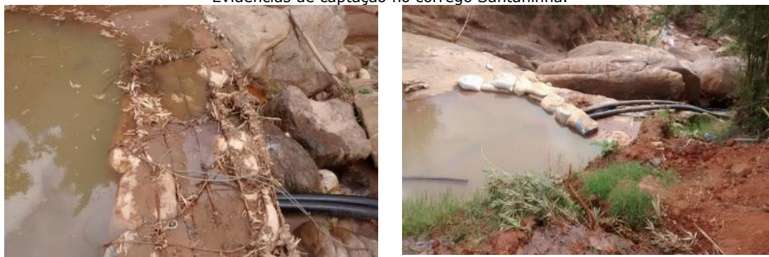
Evidências de captação no córrego Santaninha.
