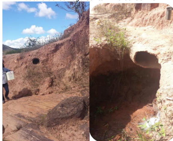
Adutora do Córrego Santaninha da COPASA.
