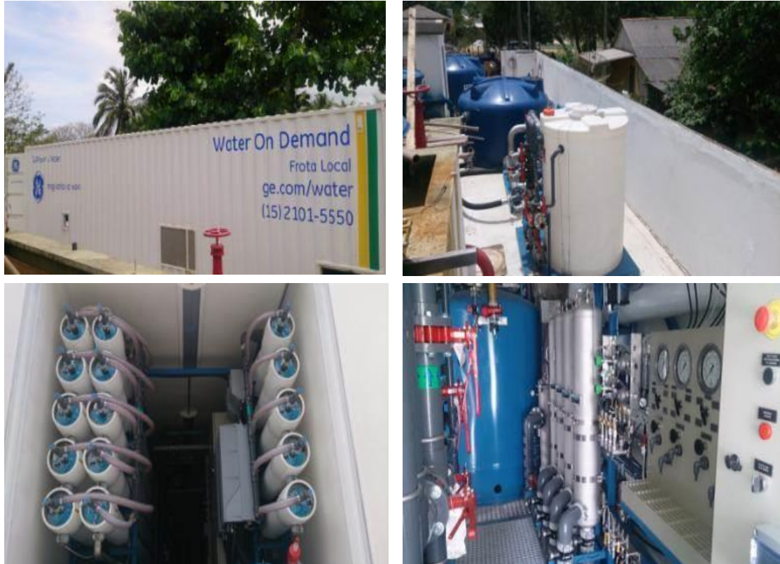
Imagens da Estação de Tratamento Móvel
