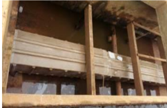
Difusor instalado em decantador da ETA Central.
